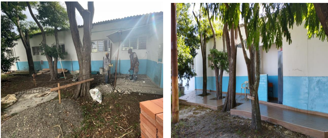
Construcción de terraza, baño y garita para guardas de seguridad antes y después
